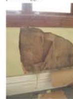
8. Svertesopp i vinduskarm.
