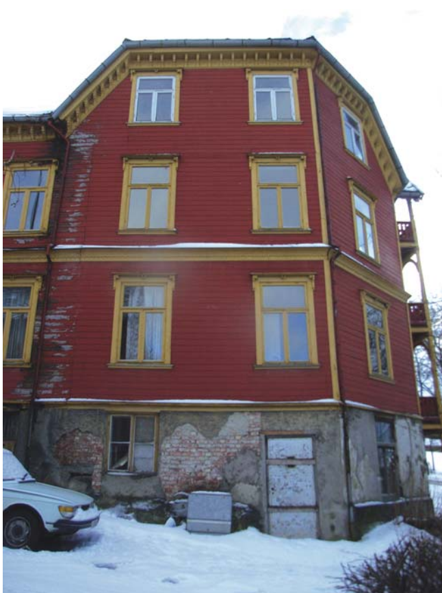
Knekk i taket i fasaden mot nord.
