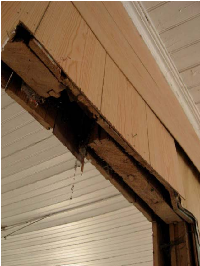
Reisverksplanker med løs fjær i en døråpning tilknyttet rom 020 i kjelleren.
